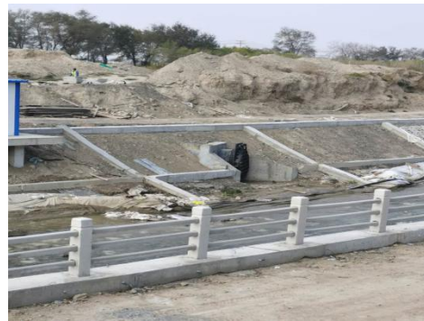
新建管道末端接口处
